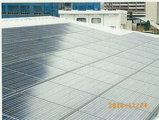
太陽光発電パネルとキュービクル
